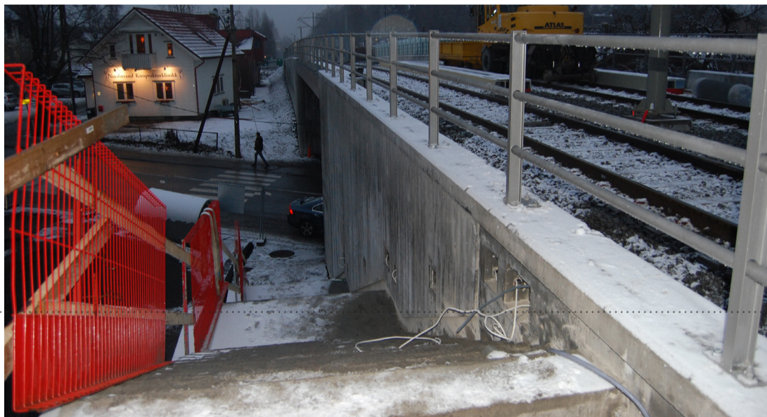
Dette skal være klart til søndag. Den nye brua på holdeplassen på Sæter har fått dobbelt spor og trapp direkte ned på Nordstrandveien.
